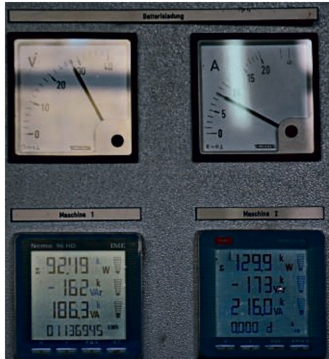
Gut geschützt stehen die elektrischen Schaltanlagen, die die verschiedensten Tätigkeiten ausführen lassen.
